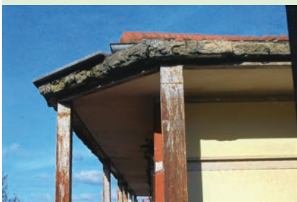
Loculi cimiteriali: aspettiamo che crollino?
